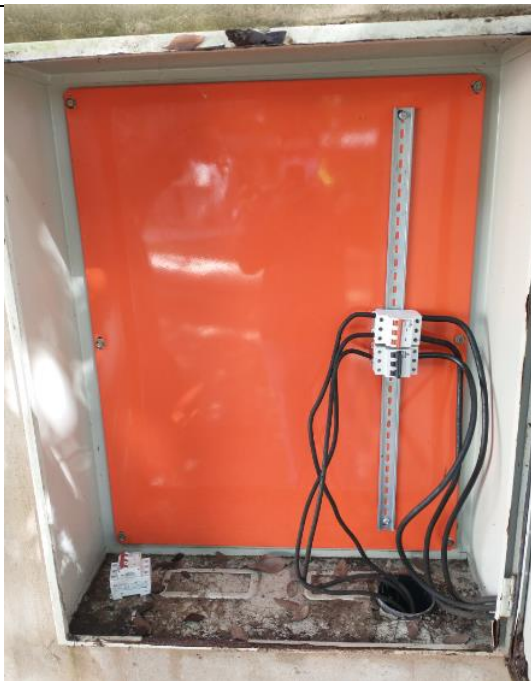
CAIXA DE PROTEÇÃO GERAL 250A BLOCO ADMINISTRATIVO 1 (ADEQUAÇÕES/LIGAÇÃO)
