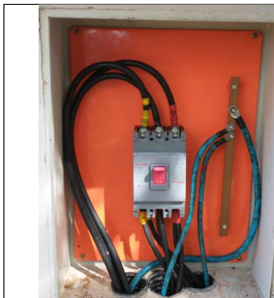
CAIXA DE PROTEÇÃO GERAL 350A BLOCO ROLDÃO
