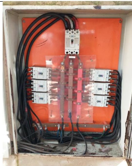
CAIXA DE PROTEÇÃO GERAL 250A BLOCO ADMINISTRATIVO 2
