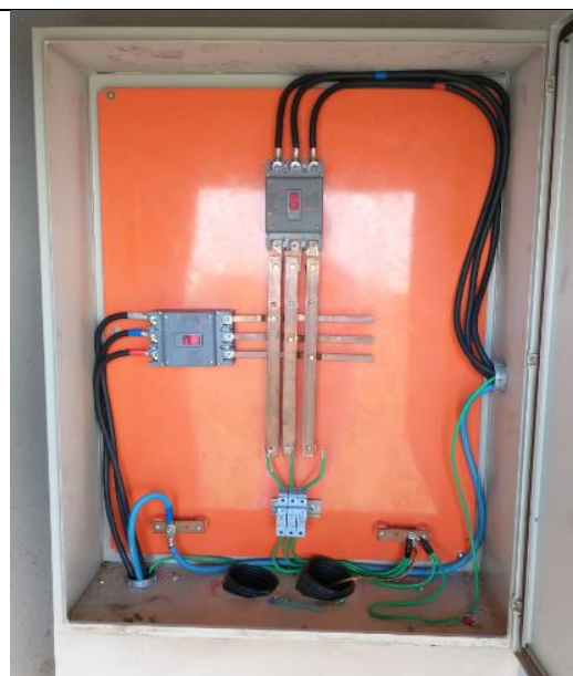
CAIXA DE PROTEÇÃO GERAL 250A BLOCO DR. CARLOS
